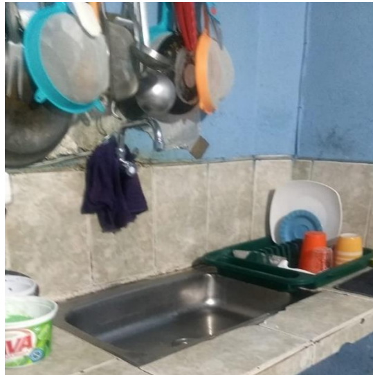
Lavabo del área de producción inadecuado
